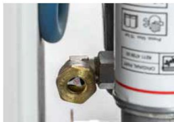
/// Controllo del livello dell'olio /// Oil level check
